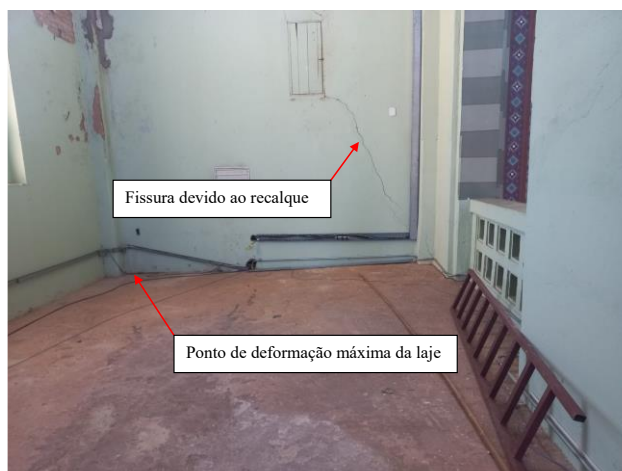
Figura 5 – Deslocamentos (Deformação) da laje interna e fissura da parede (Acervo próprio)
